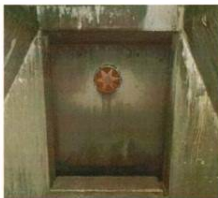
Extractores en Galería de Sedimentadores
